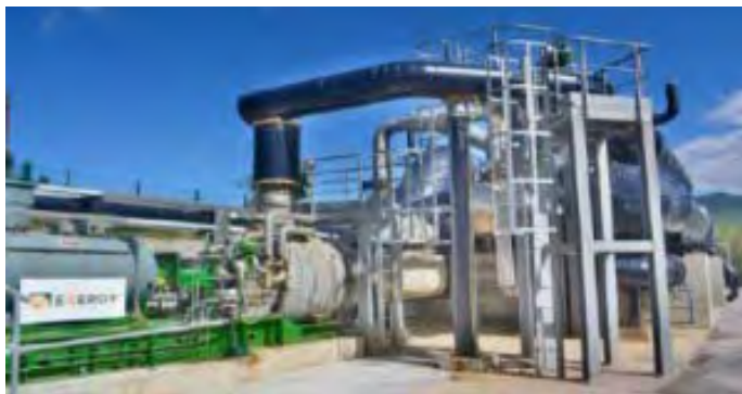
Impianto geotermico a ciclo binario da 1 MW Exergy Gruppo Maccaferri
