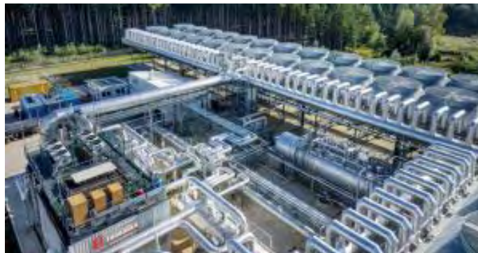
Impianto geotermico TURBODEN a ciclo binario di Kirchstockach (Germania) 5 Mwe
